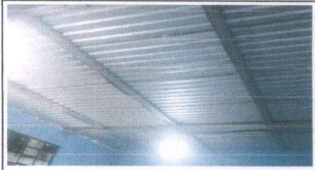
FOTO 2 Sustitución de estructura de soporte de madera, por metal, en el aula 1 y 2
